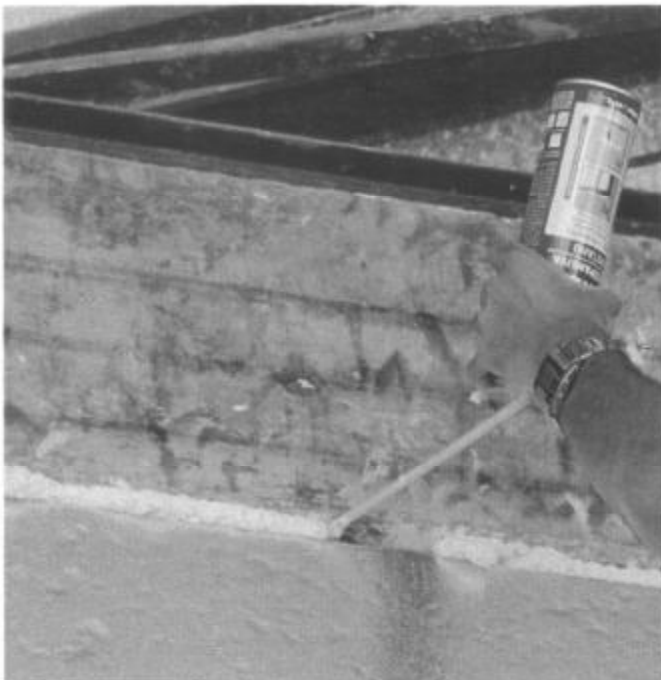
Foto 6: Aplicação de espuma expansível no encontro entre o item e o pórtilco.
